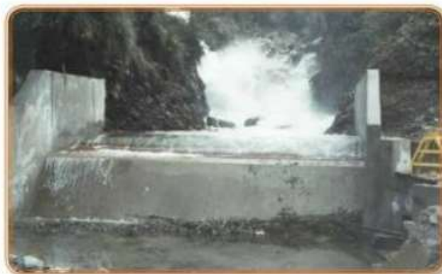
Fotografía N° 7 Tima Tirulesa sobre el Canal Paica en la subcuenca de Pórrero Mayu
