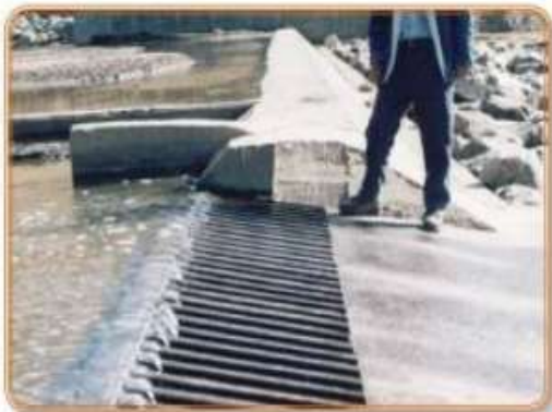
Fotografía N° 4 Vista del azud con el emplazamiento de la Tima Tirulesa en T061
